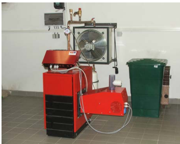
Spalovací zařízení s rotačním roštem
