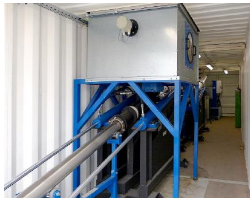
Obr. 2 Pohled na část PS01 Karbonizace technologické zkušební linky s výkonností do 20 \text{ kg.h}^{-1} vstupní suroviny v PolyComp, a.s. Poděbrady - dávkování do trubkového pyrolýzního reaktoru
