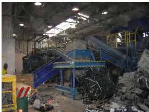
Obr. 5.1 Pohled na strojní linku výroby TAP ze spalitelných odpadů neklasifikovaných jako nebezpečné, biogenních zbytků a biomasy
