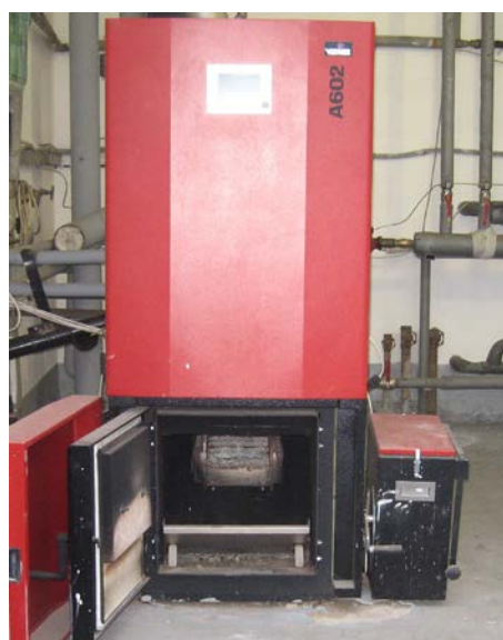
Obr. 28 Pohled na kotel při zkouškách
