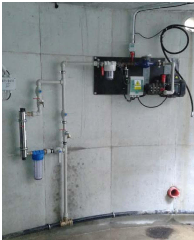
Obr. 24: Řídicí panel systému evaporačního ochlazování s mechanickým filtrem a UV lampou
