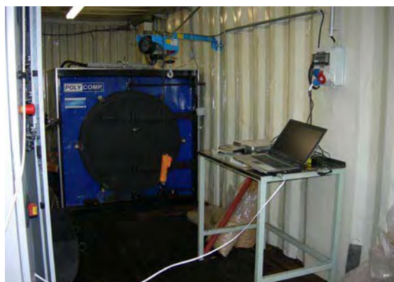
Obr. 13 Čelní pohled na termolýzní reaktor zkušební linky s řídícím pultem
