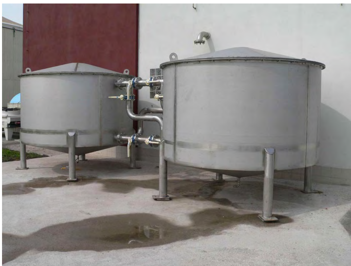
Obr. 1 Celkový pohled na odsiřovací jednotku na BPS v Kněžicích
