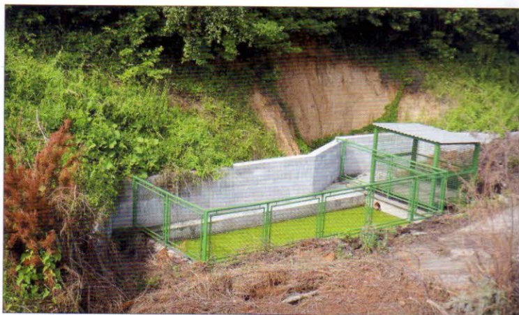
Záchytná jámka železobetonové konstrukce je umístěna vedle kompostovací plochy pod úrovní povrchu, má skladovací kapacitu 50 m 3
