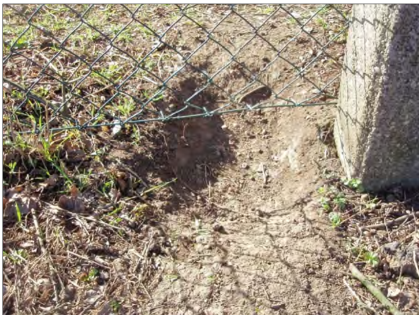
Obr. 12: Trvalé oplocení bez pevného základu nezamezí průniku zaječí zvěři
