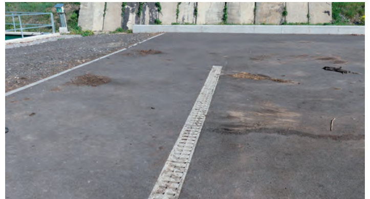
Kompostovací plocha je vodohospodářsky zabezpečena s asfaltobetonovým povrchem (celková výměra plochy 2 484 m 2 ). Ve spodní části vyspádované plochy je umístěna záchytná šachta, z které jsou vody z povrchu plochy svedeny do záchytné jímky
