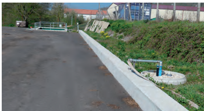
System rozvodu kapaliny pro regulaci vlhkosti kompostovaných surovin
