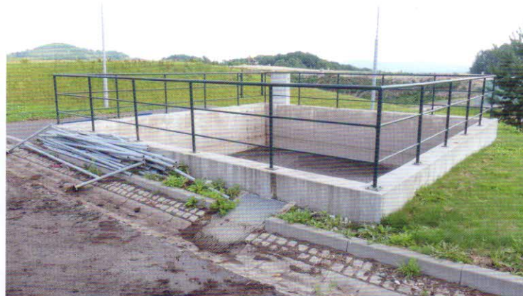
Záchytná jímka je umístěna vedle kompostovací plochy pod úrovní povrchu, jímka je optocena kovovým zábradlím; skladovací kapacita jímky 100 m 3
