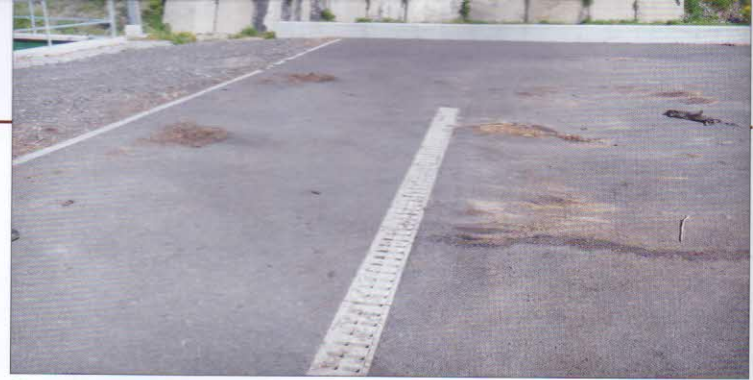
Kompostovací plocha je vodohospodářsky zabezpečena s asfaltobetonovým povrchem (celková výměra plochy 2 484 m 2 ). Ve spodní části vyspádované plochy je umístěna záchytná šachta, z které jsou vody z povrchu plochy svedeny do záchytné jímky
