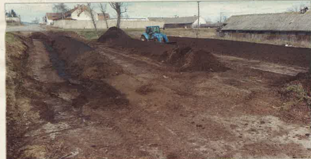
Kompostovací plocha (1250 m 2 ) je vodohospodářsky zajištěná, její povrch je vytvořen z betonových panelů. Pod plochou je vybudován podzemní svodový systém, který kapaliny z plochy odvádí do uzavřené záchytné jímky vedle plochy Foto Petr Plíva
