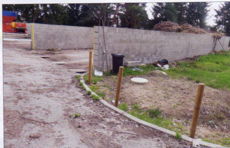
Kruhová plastová záchytná jímka je umístěna vedle vodohospodářsky zabezpečené plochy pod úrovní povrchu; voda je do jímky svedena sběrným otevřeným žlabem; kapacita jímky min. 14 m 3
