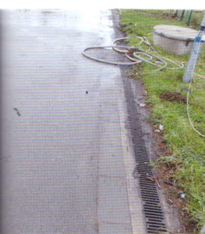
Systém svodu vody z kompostovací plochy (kanálek, obrubníky)
