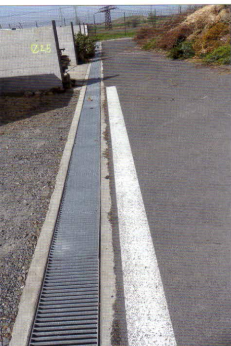
Zadržování vod z kompostovací plochy v záchytné jímce – voda z kompostovací plochy je zachycena příčným žlábkem a je svedena do záchytné jímky, která je umístěna bezprostředně vedle kompostovací plochy pod úrovní povrchu; skladovací kapacita – 326 m 3 ; rozvod vody z jímky kolem kompostovací plochy do dvou hydrantů
