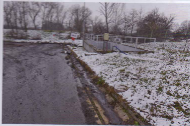
Tři záchytné jímky železobetonové konstrukce jsou umístěny po obvodu kompostovací plochy, částečně pod úrovní povrchu, s celkovou skladovací kapacitou 253 m 3
