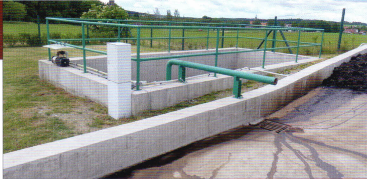
Záchytná jímka železobetonové konstrukce se skladovací kapacitou 80 m 3 je umístěna vedle kompostovací plochy pod úroveň povrchu. Stěny jsou tvořeny speciální vodonepropustnou fólií
