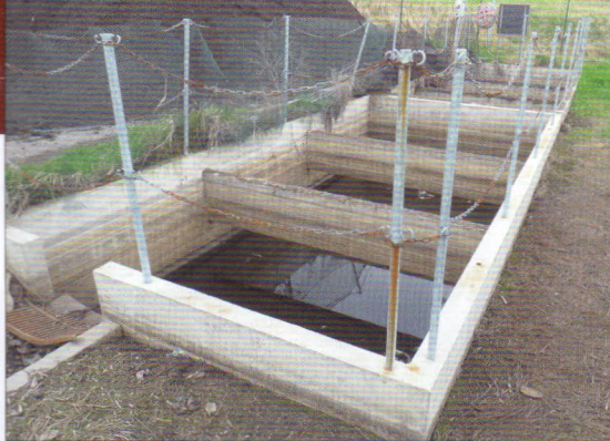
Zadržování vod z kompostovací plochy – záchytná jímka železobetonové konstrukce s ponorným kalovým čerpadlem je umístěna bezprostředně vedle kompostovací plochy pod úrovní povrchu (skladovací kapacita 108 m 3 )
