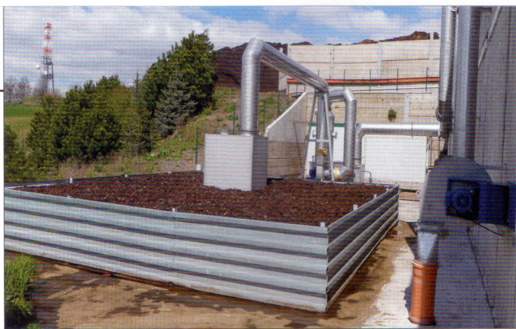
Rozvody vzduchotechniky do halové kompostárny s biofiltrem
