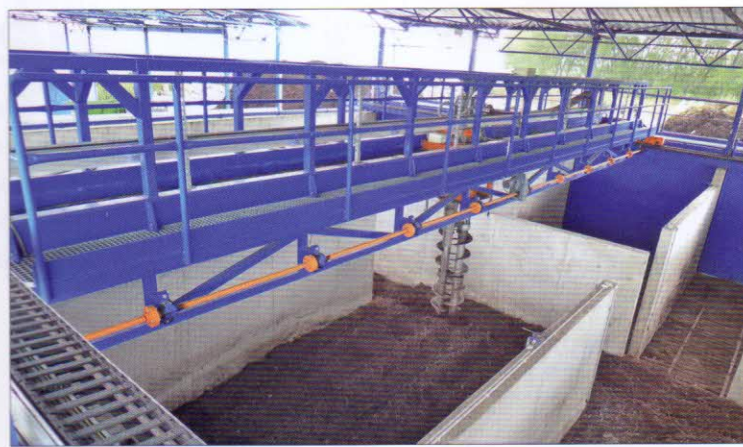
Obr. 10 – Dvourotorové promíchávací zařízení v jedné z komor
