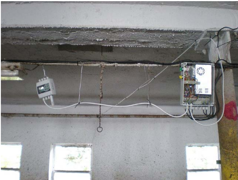
Obr. 2: pohled na snímač parametrů stájového mikroklimatu a řídicí jednotku
