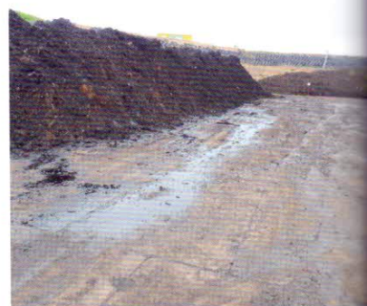
Venkovní kompostovací plocha je vodohospodářsky zabezpečená, je vybudovaná z betonových panelů s možností překlada plochy na jiné místo na tělese skládky. Celková výměra plochy 5900 m 2 , tj. 100 x 59 m. Plocha je příčně a podélně vyspádovaná
