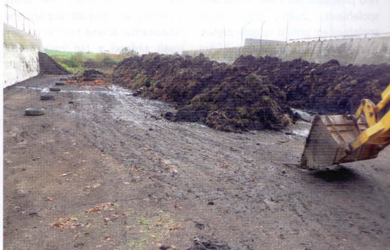
Vodohospodářsky zajištěná kompostovací betonová plocha (dno silážního žlabu) – obdélníkový půdorys s odpadní záchytnou jímkou. Velikost plochy 50 x 60 m
