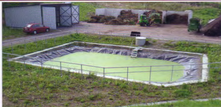
Záchytná jímka je umístěna vedle kompostovací plochy pod úrovní povrchu se skladovací kapacitou 63,1 m 3 . Stěny jsou tvořeny speciální vodonepropustnou fólií
