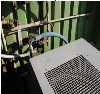
Obr. 3: Detail výstupu vzduchu z odsiřovací jednotky kde došlo k porušení materiálu plastové hadice, koleno bylo nahrazeno kovovou součástí
