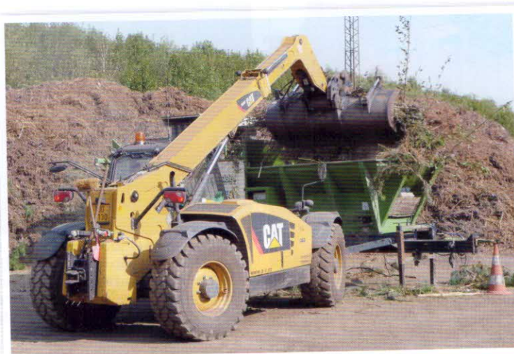
Manipulace se surovinami – teleskopický manipulátor Caterpillar TH 407 s dieselovým motorem 93 kW, lopatou 2 m 3 a vidlemi (výška zdvihu 7 m)
