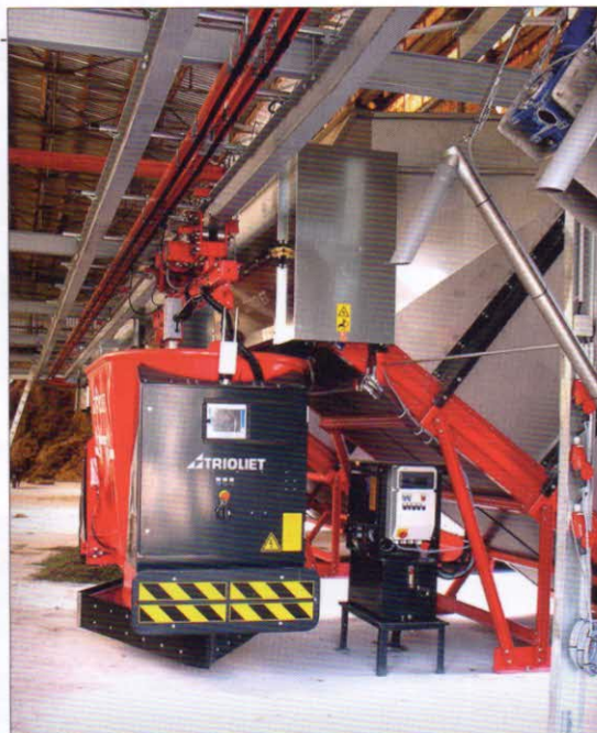
První poloautomatický systém firmy Trioliet, varianta T30, je v provozu na farmě pana Kubělky v Záluží u Sušice. V meziskladu je instalována soustava paralelně uspořádaných dávkovacích zásobníků pro objemové krmivo a zásobníků s dávkovačem pro krmné směsi a další komponenty krmné dávky. Příprava krmné dávky a její plnění do krmného vozíku řídí počítač
