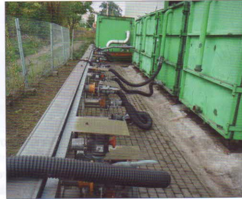
Vzduchotechnické připojení kontejnerů – dodávka vzduchu do jednotlivých kontejnerů. Dodávané množství vzduchu – 690 m 3 /h
