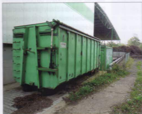
Vzduchotechnická úprava odfuku – biofiltr (náplň štěrka a kůra) s pracovním objemem 25 m 3
