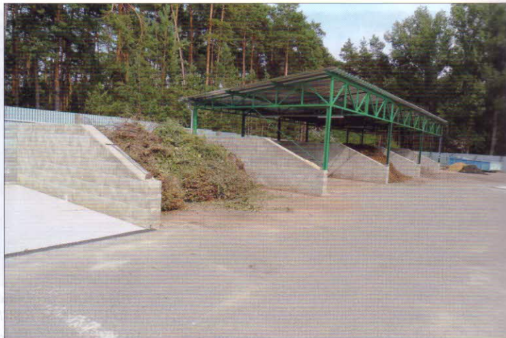
Uskladnění surovin a vyrobeného kompostu – kompostovací betonový box (tři zastřešené, čtyři nezastřešené), objem jednoho boxu je 90 m 3
