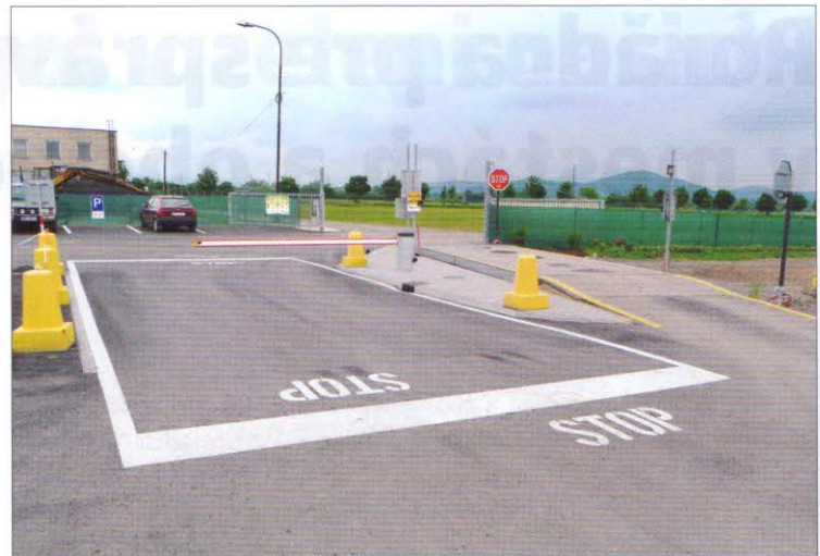
Evidence přijímaných surovin a expedovaného kompostu – automatická mostová silniční váha s dálkovým přenosem dat LEON ENGINEERING, LD 5204, váživost do 40 t, přesnost ± 20 kg
