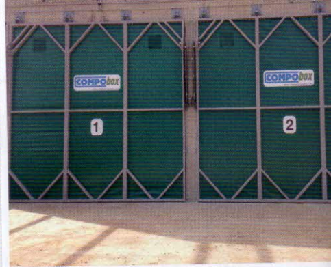
Hygienizační jednotky – Compost Systems COMPOBOX (2 kusy) slouží k hygienizaci kuchyňských zbytků a BRKO (zatím nevyužívají). Technologie úpravy – kompostování s částečným dohříváním na požadovanou teplotu 70 °C po dobu jedné hodiny. Sestava dvou jednotek – kapacita – 520 m 3 BRO (gastroodpadů) denně. Velikost plochy – (28 x 12) m
