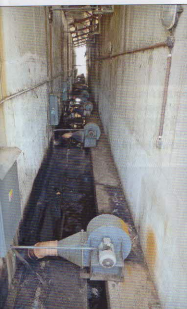
Zajištění aerace zpracovávaných surovin – vzduchotechnický systém se sedmi provzdušňovacími kanálky ve dně žlabu (kanálky s průřezem 180 x 200 mm a délce 6 m. Dvacet ventilátorů s výkonností max. 3000 m 3 /h
