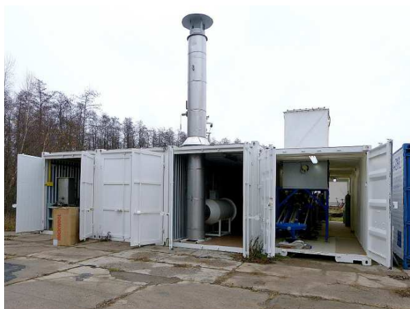
Obr. 13: Kontejnerové umístění vývojové a zkušební technologické linky VÚZT, v.v.i. Praha - PolyComp, a.s. Poděbrady pro karbonizaci a zplyňování zbytků a odpadů s výkonností 20 kg/h vstupní suroviny
