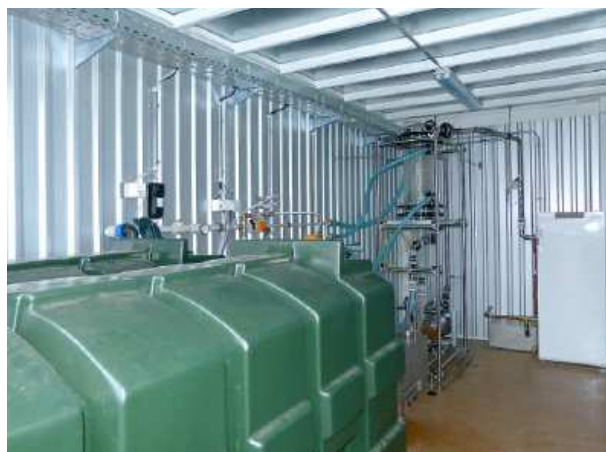
Obr. 14: Pohled na část provozního souboru chlazení a čištění syntézního plynu linky VÚZT, v.v.i. Praha - PolyComp, a.s. Poděbrady s nádržemi provozních kapalin a kondenzačních odpadů a prací kolonou surového syntézního plynu
