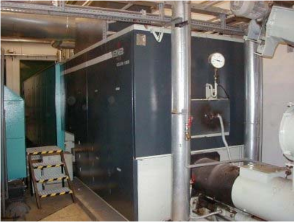
Obr. 1: Měřený kotel Verner 1 800 kW
