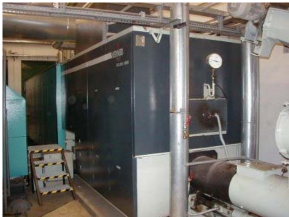
Obr.1: Měřený kotel Verner 1 800 kW
