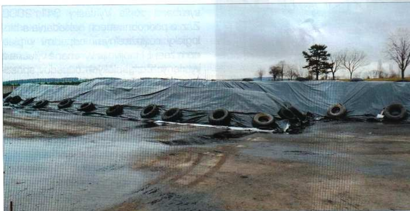
Kompostovacia plocha je súčasťou areálu skládky. Ide o vodohospodársky zabezpečenú plochu (1500 m 2 ) vrátane zvodov do záchytnéj nádrže. Jímka má objem 76 m 3
