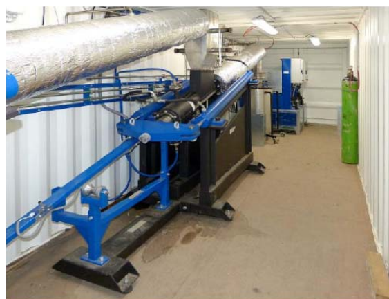
Obr. 9: Pohled na část zplyňovacího reaktoru s výsypkou technologické zkušební linky 20 \text{ kg}\cdot\text{h}^{-1} vstupního materiálu
