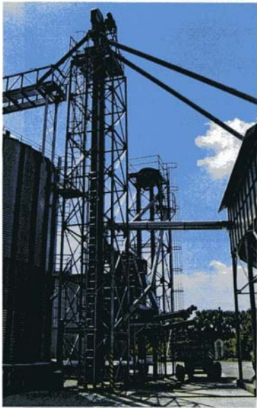
Systém vertikální dopravy korečkovými elevátory o výkonnosti 120 t/h, který je umístěn v příhradové ocelové konstrukci
