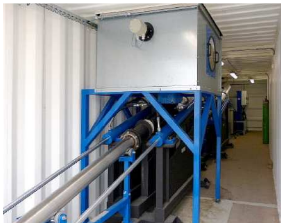
Obr. 21: Pohled na část PS01 Karbonizace technologické zkušební linky s výkonností do 20 \text{ kg}\cdot\text{h}^{-1} vstupní suroviny v PolyComp, a.s. Poděbrady - dávkování do trubkového pyrolýzního reaktoru
