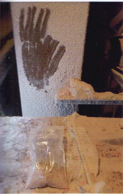
Obr. 5 - Detail znečištění přechodu z korečkového elevátoru na řetězový dopravník Foto Jiří Bradna
