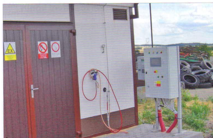
Kompresní stanice na zemní plyn – CNG stanice s výdejním stojanem a plnicí pistolí byla instalována v Družstvu Pooslaví koncem roku 2016
