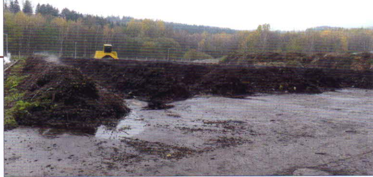
Fermentační (kompostovací) plocha je vodohospodářsky zabezpečena, je členěna do devíti samostatně odvodňovaných sekcí, podélně vyspádaných; povrch plochy je betonový; rozměry plochy 72,5 x 45,5 m; celková velikost fermentační plochy 3300 m 2
