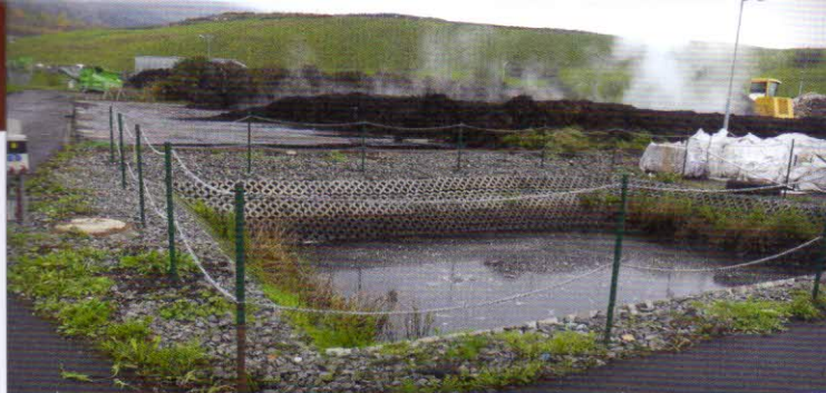
Záchytná jímka – znečištěná voda je svedena z jednotlivých vyspádaných sekcí do betonové záchytné jímky (objem jímky 80 m 3 ). Voda akumulovaná ve sběrné jínce může být zpětně využívána na zkrápění kompostu
