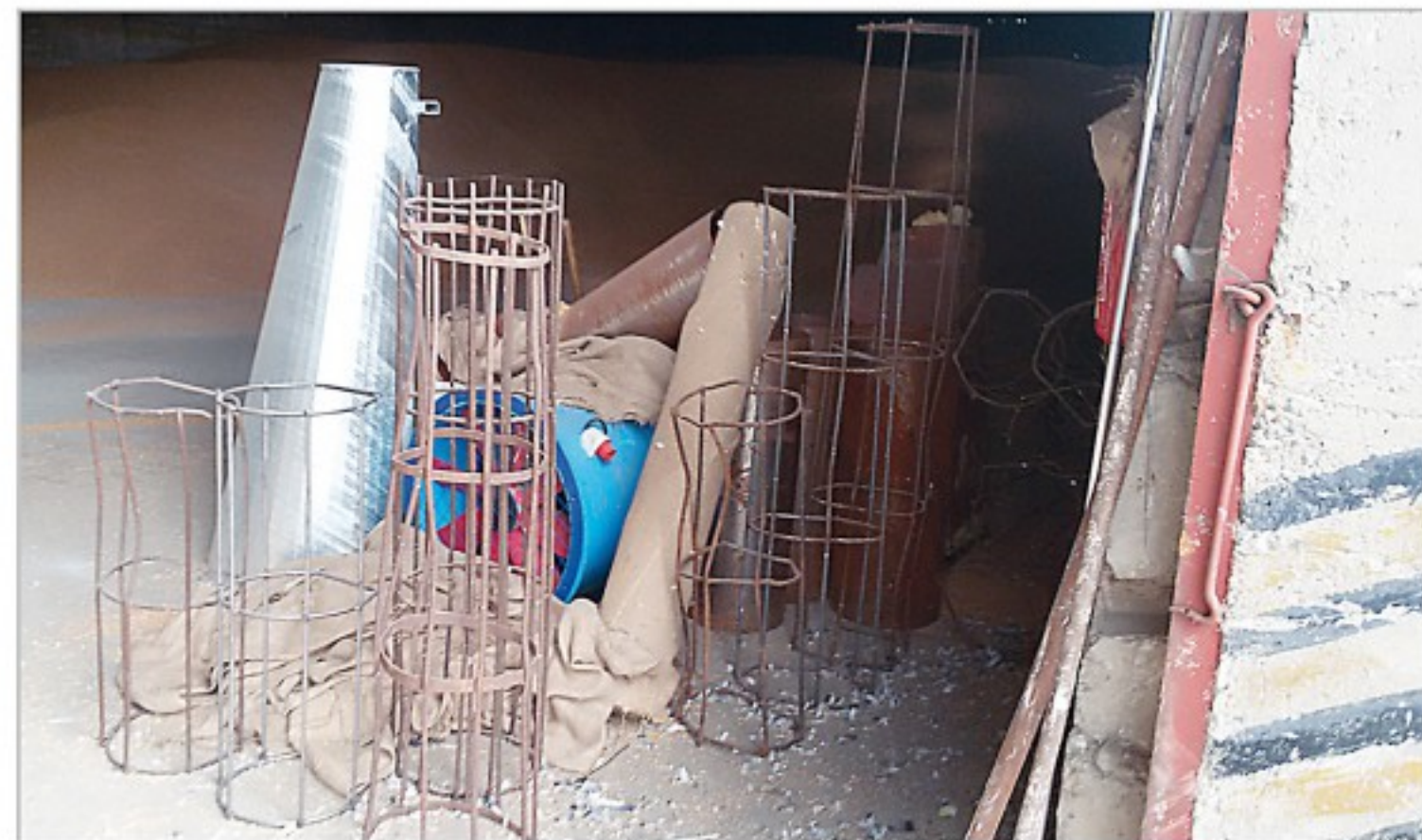
Detail klecových kanálů a napojení axiálního ventilátoru Foto archiv autorů článku
