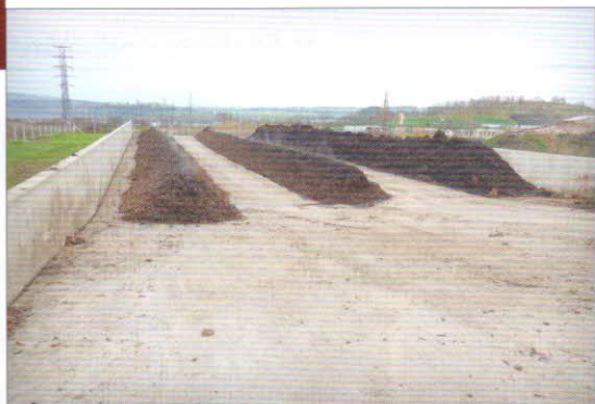
Kompostovací plocha – nově vybudovaná vodohospodářsky zajištěná betonová plocha s betonovými mantinely po delších stranách vysokými zhruba 2 m a se svodem do záchytné jímky. Kompostovací plocha má rozměry 20 x 60 m (1200 m 2 )
