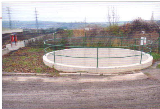
Záchytná jímka je umístěna v bezprostřední blízkosti kompostovací plochy pod úrovní povrchu s následujícími parametry: vnější průměr jímky – 7,6 m; max. hladina kapaliny nade dnem – 3,4 m; hloubka pod okolním terénem – 5,55 m; skladovací kapacita – 130,78 m 3
