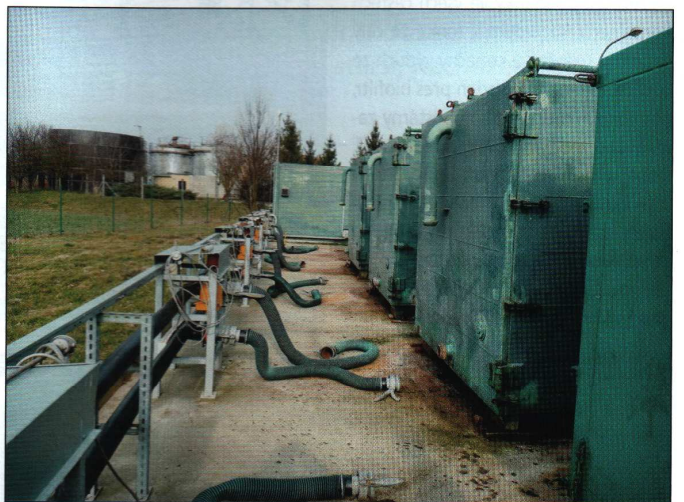
Vzduchotechnické připojení kontejnerů – dodávka vzduchu do jednotlivých kontejnerů (ventilátor s el. motorem 11 kW, dodávané množství vzduchu – 690 m 3 /h). Odsávání vzduchu z jednotlivých kontejnerů ventilátorem (11 kW), dodávané množství vzduchu 690 m 3 /h
