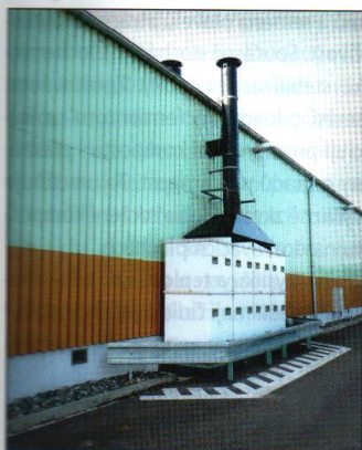
Vzduchotechnické prvky – kazetový biofiltr BFK 8 s náplní plastové stříže a dřevní štěpky a pracovním objemem 8 m 3 je umístěn vně haly
