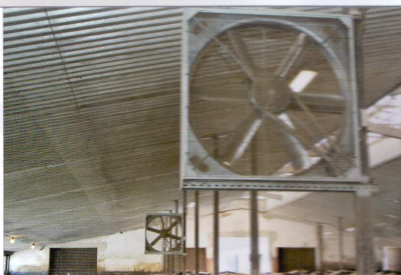
Proudění vzduchu ve stáji napomáhá také osazení ventilátory
