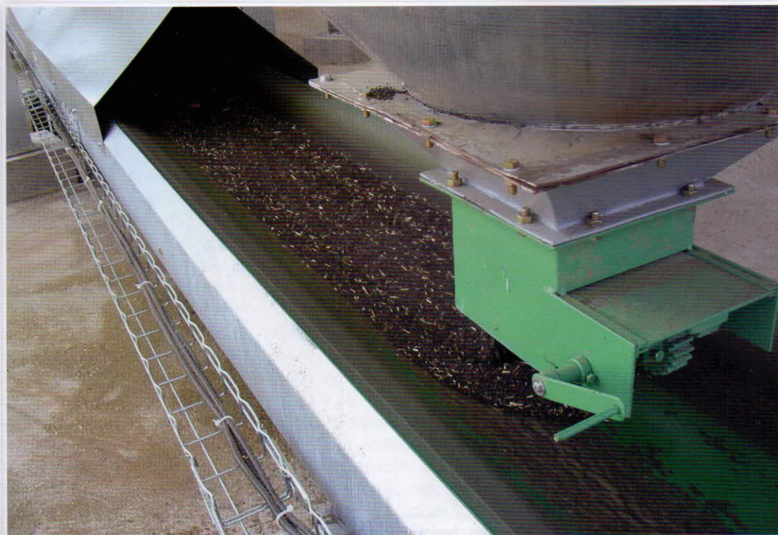
Pásový dopravník umístěný pod kuželovou výsypkou věžového zásobníku
